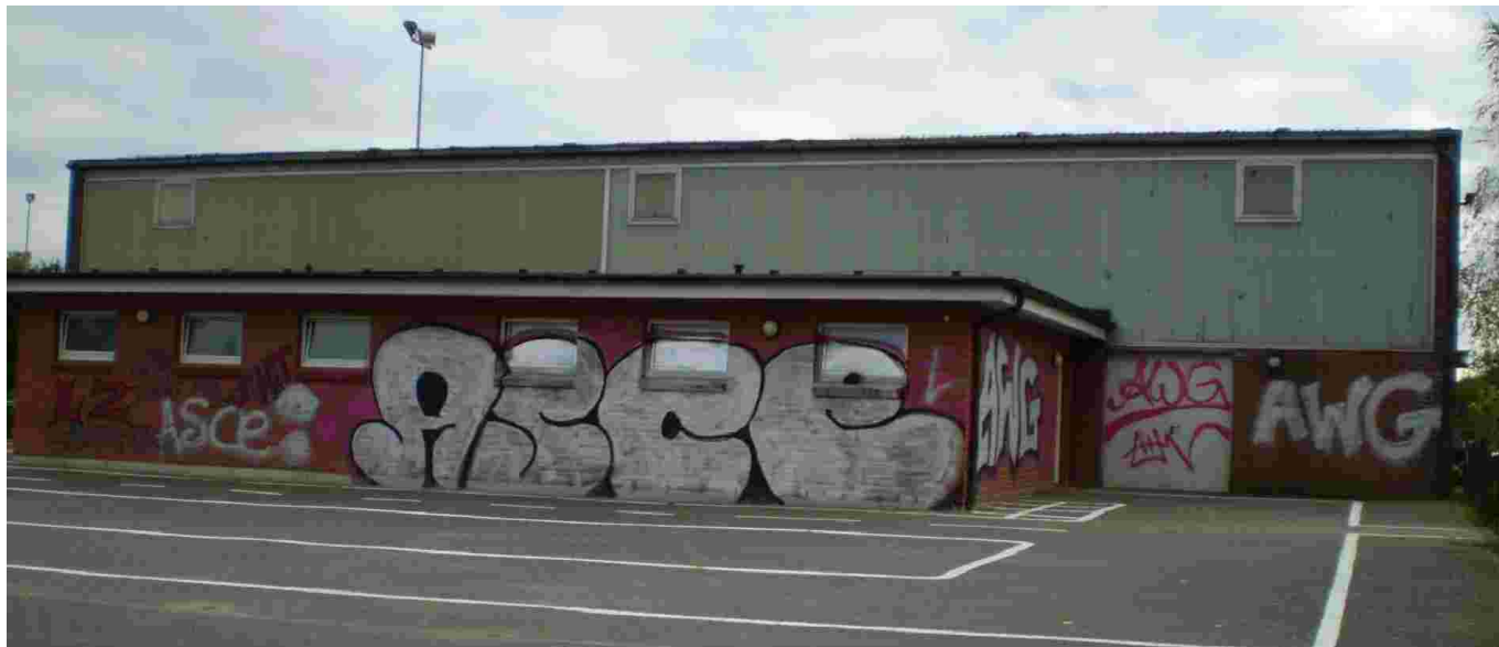
Die Turnhalle von hinten: Das Entfernen der Farbe würde 1.400 Euro kosten. Zunächst lässt die Gemeinde es so.
