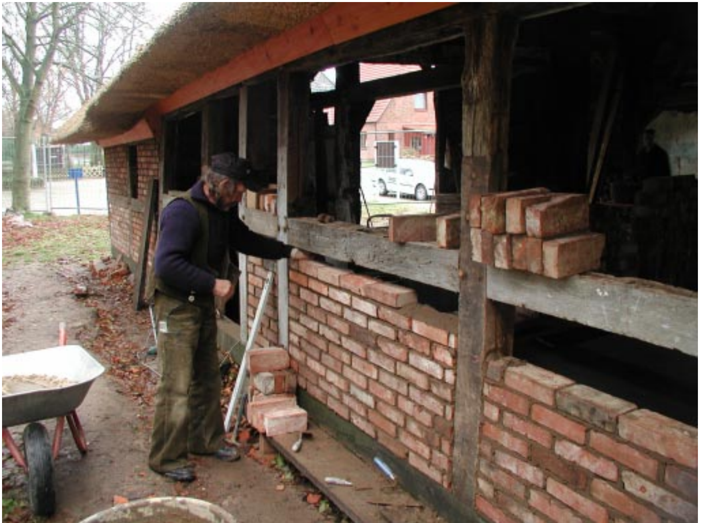
Die Röperkate steht jetzt im Denkmaltbuch des Landes. Hier das Ausmauern von Fachen mit Lehmörtel.
